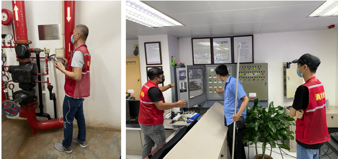
设备安全检查
