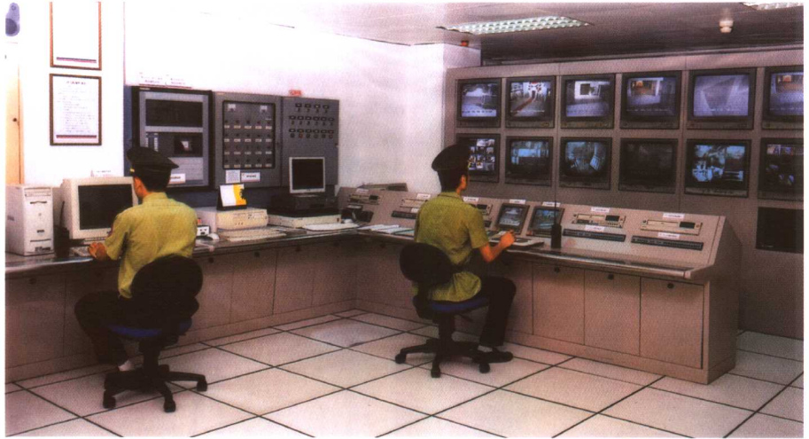
296. 监控中心机房
