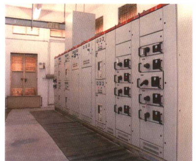
299. 本馆2000千瓦的变电站和 配电设施
