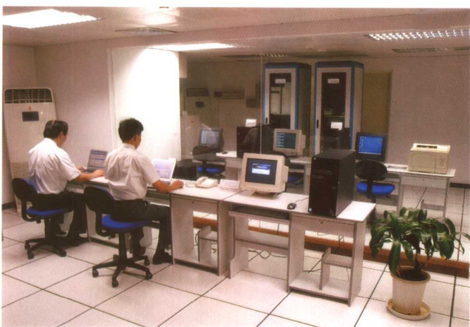
301. 电脑网络中心机房
