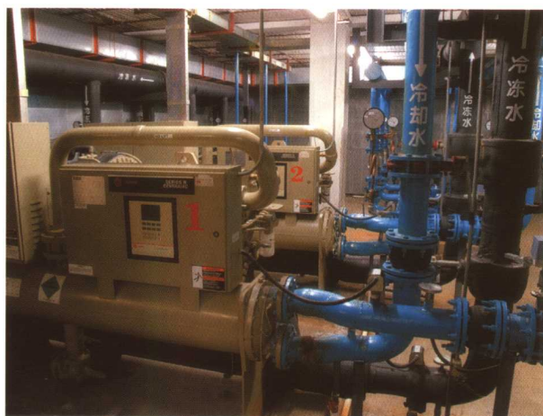
302. 展馆中央空调主机
